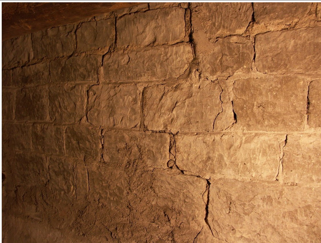
Detail románského tzv. kvádříkového zdiva s podřezávanými spárami v 1. patře věže. Foto: Jaroslav Skopec 2014.
