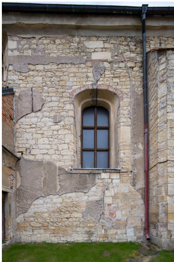
Detail zdiva mezi severní strany lodi mezi sakristií a východním opěrákem. Ve spodní partii fragment předpokládaného gotického zdiva užívajícího druhotně románské prvky. Foto: Marta Pavlíková 2014.
