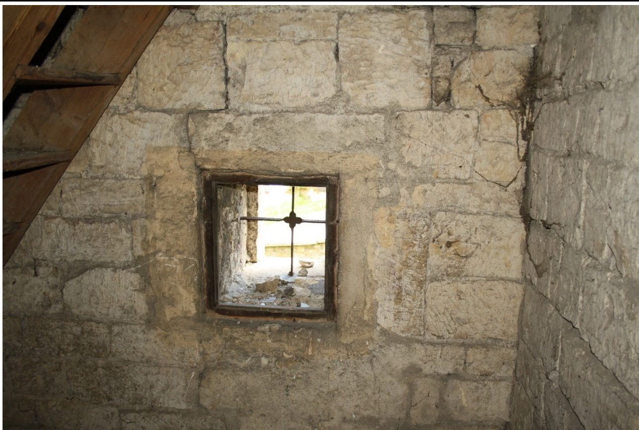
Severní okenní otvor 1. patra věže v pohledu od jihu. Foto: Jaroslav Skopec 2015.
