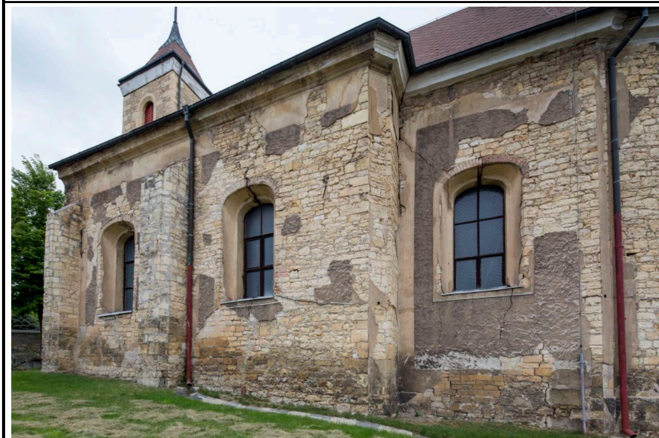
Jižní průčelí lodi a presbytáře v pohledu od jihovýchodu. Foto: Foto: Marta Pavlíková 2014.
