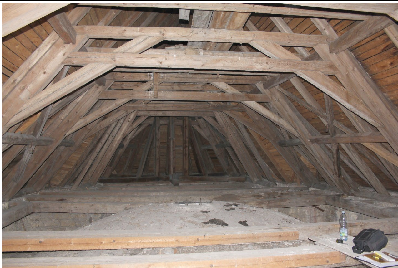
Pohled od západu do krovu nad lodí a presbytářem. Foto: Jaroslav Skopec 2018.
